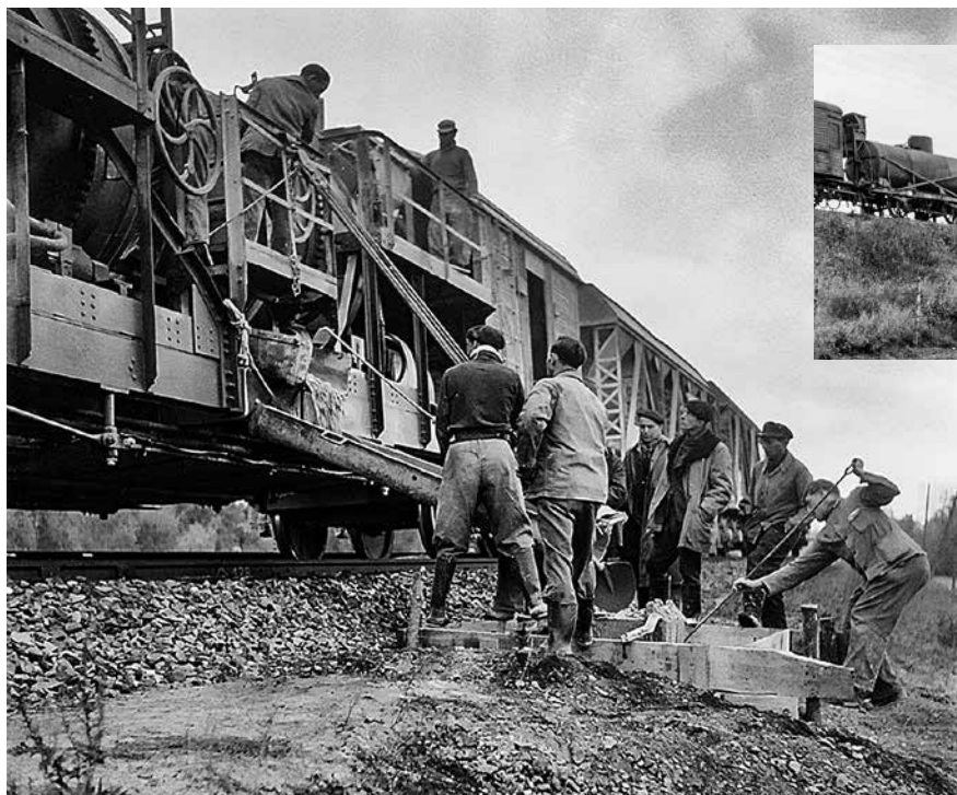
Betonování patek stožárů trakčního vedení během elektrifikačních prací na trati Paříž – Lyon.
